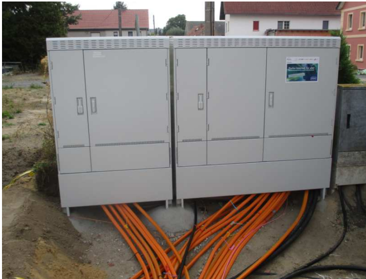
Bild: Hauptverteiler in Folbern (ENSO Netz GmbH)
